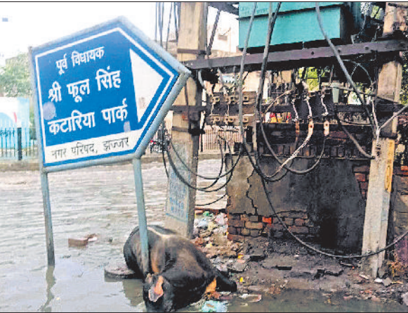
झज्जर। करंट की चपेट में आने से ट्रांसफार्मर के साथ मृत पड़ा गौवंश।
